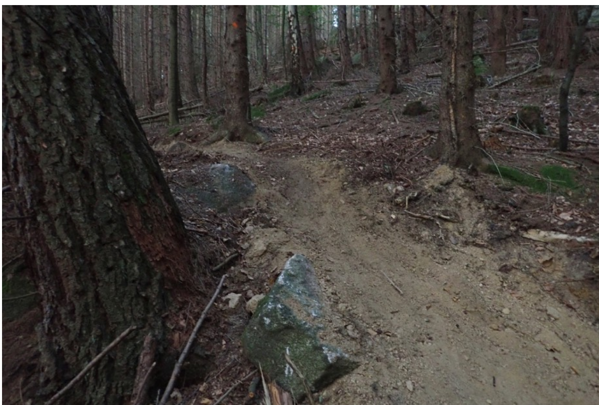
Brak wykonanych dodatkowych budowli na trasie progów (sekcja nr 43)
