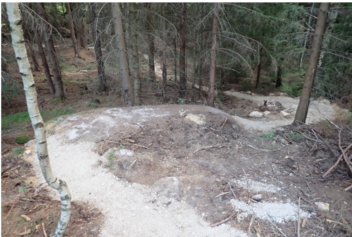
Brak wykonanej nawierzchni wzmocnionej z ułożonych kamieni (sekcja nr 43)
