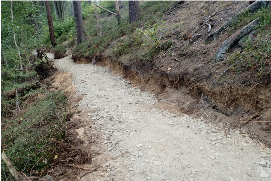
Brak skarpowania. Dolna krawędź ścieżki zbudowana na warstwie organicznej (sekcja nr 50)
