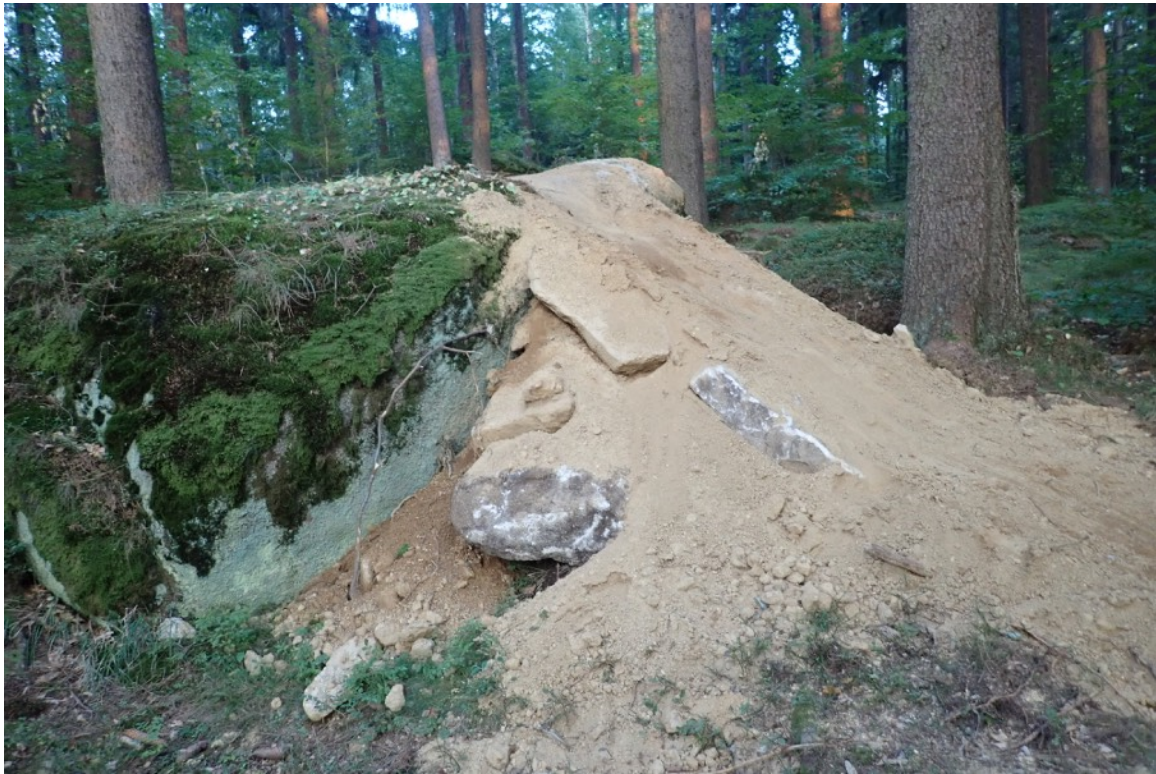
Brak umocnień kamiennych na bokach zjazdu, niezagęszczony zjazd (sekcja nr 43)
