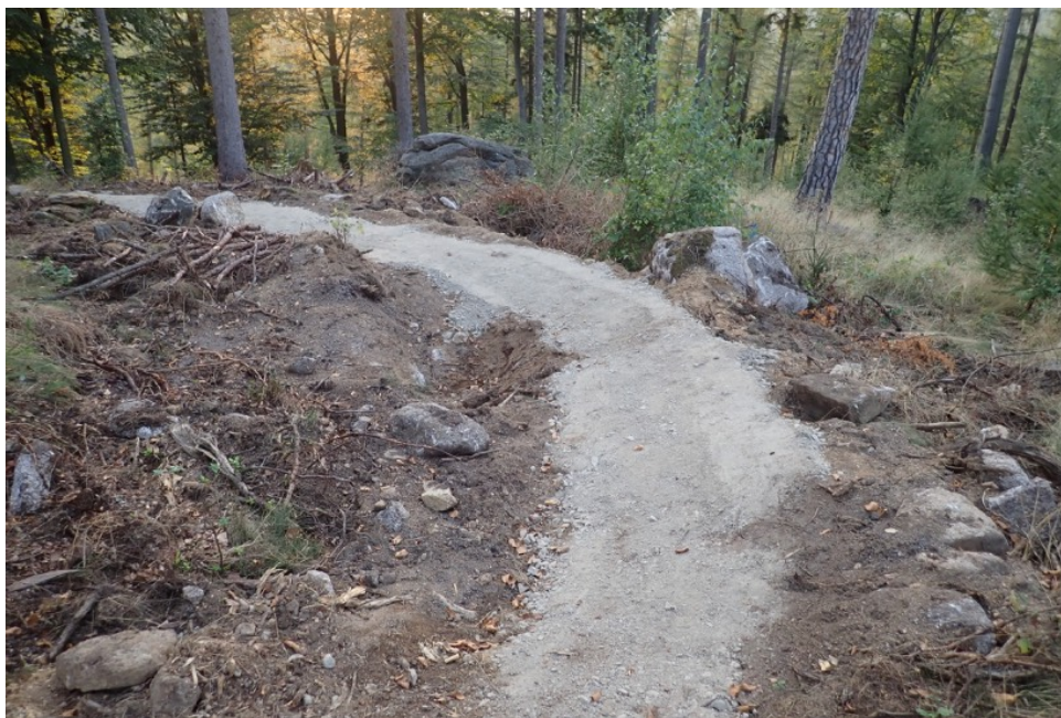
Brak odwodnienia rurowego (sekcja nr 43)
